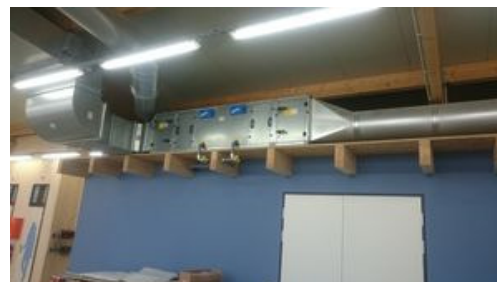
Bild 3: Zu- und Abluftgerät
