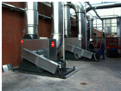
Wentylator ssący z izolacją akustyczną
