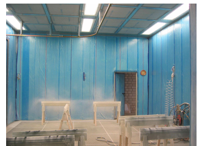
Lackiererraum mit Unterflurabsaugung
