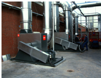
Absaugventilatoren mit Schallisolierung
