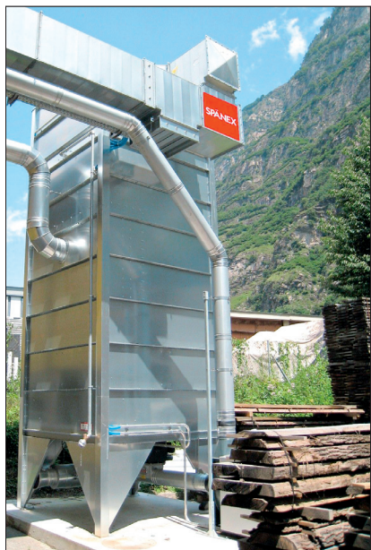
Filteranlage mit integriertem, drehzahlregulierten Absaugventilator
