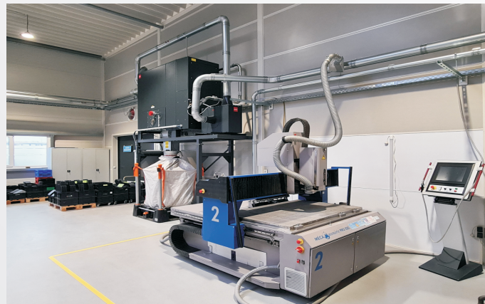
Zentrale Absauganlage mit Stützventilator
