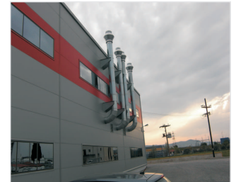
Abluftrohre mit Deflektorhauben
