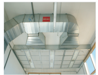
Zuluftdecke mit Beleuchtung
